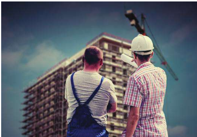
On site management ควบคุมและจัดการการก่อสร้างโดยทีมงานมืออาชีพ
